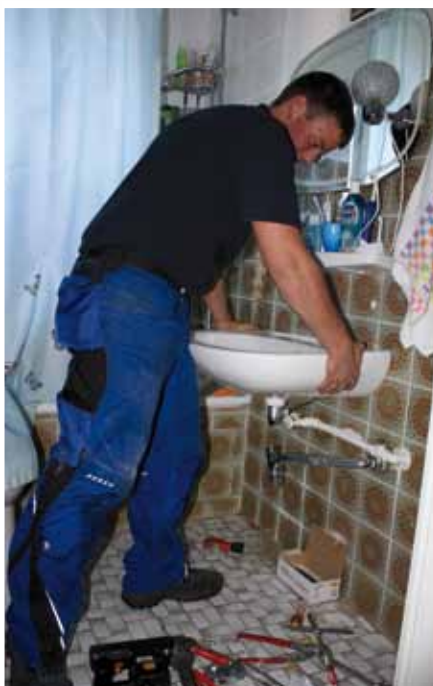
Daniel Huckschlag (27) ist erst seit kurzem bei der GBS und Fachmann für Sanitäranlagen. Er schließt gerade ein neues Waschbecken an.
